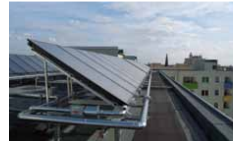
Abb. 4: Solarthermie-Anlage R. Upmann
