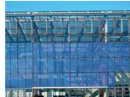
Abb. 9: Fassadenanlagen können oft nicht auf Anrieb erkannt werden. Sie können auch halb transparent ausgeführt sein.
